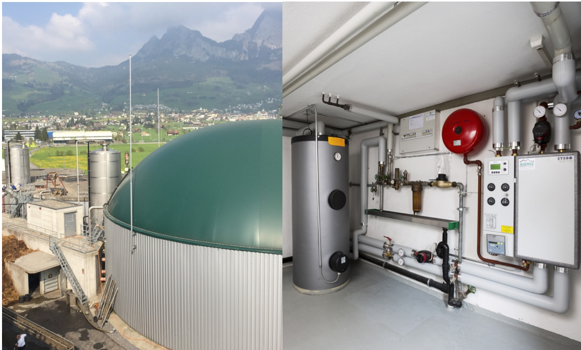
Abbildung 12: Bilder der Biogasanlage Agro Energie Schwyz mit Aussensicht auf Fermenter (links) und Heizzentrale (rechts).
