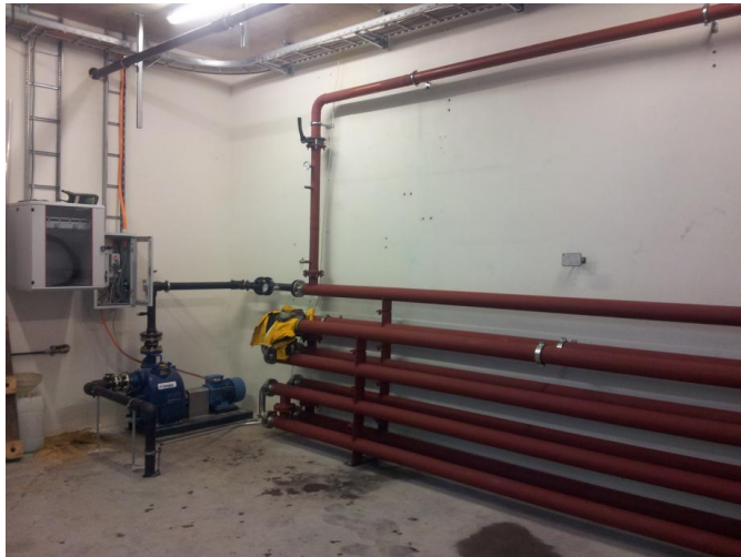
Abbildung 3: Externer Güllewärmetauscher in der Heizzentrale der Firma Peter Briner AG
