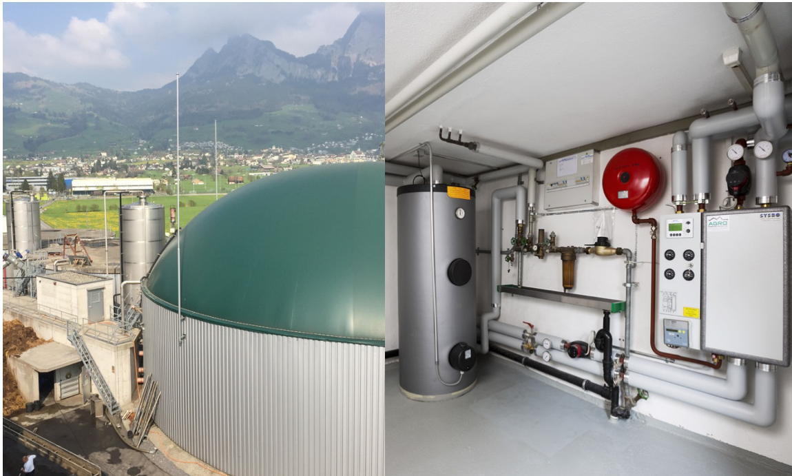
Figure 12: Photos de l'installation de biogaz Agro Energie Schwyz, vue extérieure du digesteur (à gauche) et centrale de chauffage (à droite).
